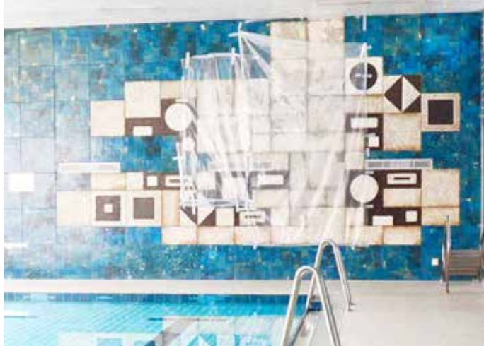
Zu viele Fliesen sind aus dem Wandbild an der westlichen Stirnseite der Schwimmhalle herausgefallen.
