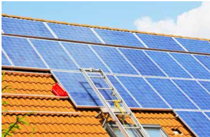
Die Stromproduktion auf dem eigenen Dach spart Geld und schont das Klima – Vorsicht aber vor dubiosen Angeboten an der Haustür! Bild: KEA
